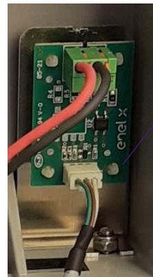
Placa de controle
